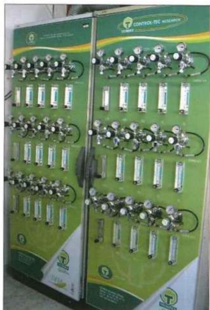
Foto 4. Sistema de mezcla de gases para la aplicación de choques gaseosos.
